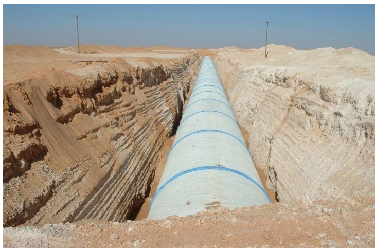
Tubazioni del Great Project Libico
