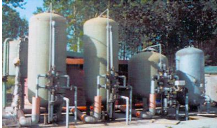
Impianto di depurazione delle acque con carboni attivi
